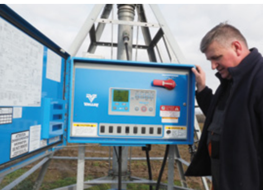
Każda wieża deszczowni jest wyposażona w skrzynkę sterującą, programowanie pracy urządzenia nie jest skomplikowane – wyjaśnia Waldemar Mania
